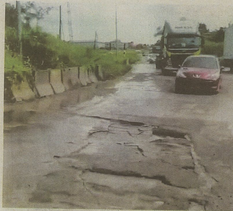
BEGINILAH keadaan jalan yang rosak hingga mengancam nyawa pengguna di Pelabuhan Klang.
