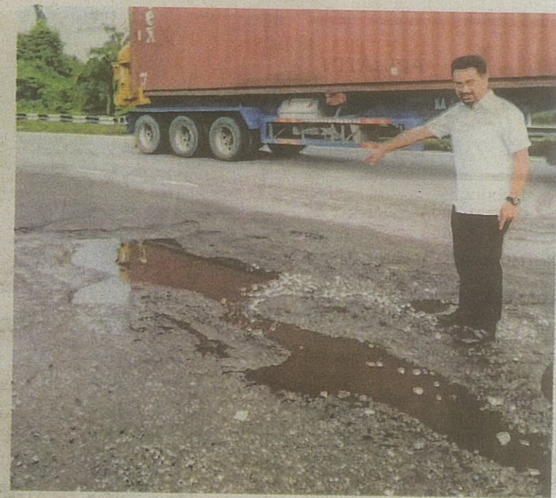
AZMIZAM menunjukkan antara lopak air yang terbentuk akibat keadaan jalan yang rosak teruk sejak setahun lalu di Pelabuhan Klang.
