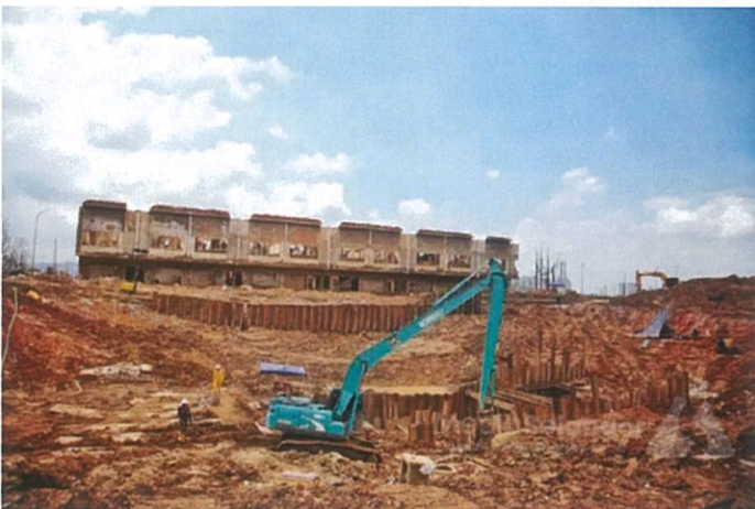
Keadaan terkini di sekitar kawasan letupan paip gas di Putra Heights, Subang Jaya ketika lawatan media ke lokasi berkenaan pada 30 April 2025. Foto MOHD KHAIRUL HELMY MOHD DIN/MEDIA SELANGOR
