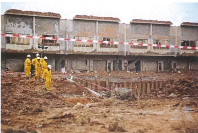
Situasi terkini di sekitar lokasi kebakaran saluran paip gas di Putra Heights pada 30 April 2025. Foto MOHD KHAIRUL HELMY MOHD DIN/MEDIA SELANGOR
