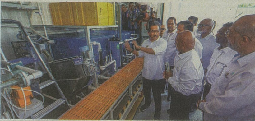
JOHARI Abdul Ghani melihat mesin Rawatan Efluen Kilang Kelapa Sawit (POME) tanpa kolam rawatan selepas melancarkan teknologi RT Eco di Seri Morib Palm Oil Mill Sdn Bhd, Morib, di Kuala Langat, Selangor, semalam.
