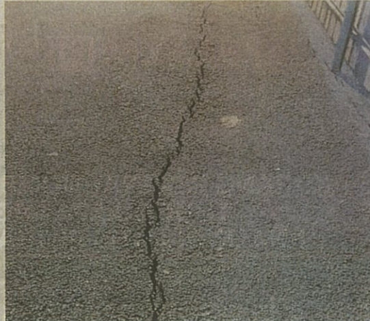
Jalan berhampiran Pangsapuri Petaling Utama dikesan alami keretakan yang semakin serius. (Foto Kalbana Perimbanayagam/BH)
