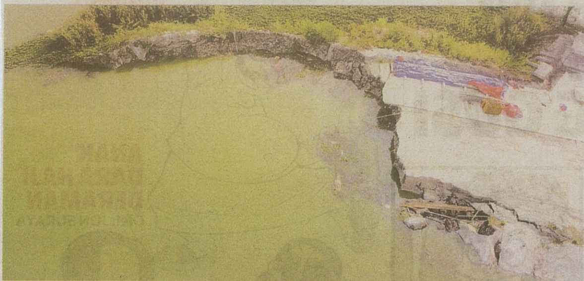
TEBING sungai yang runtuh di tapak pembinaan projek Skim Bekalan Air Sungai Rasau (Peringkat 1) di Puchong kelmarin.
