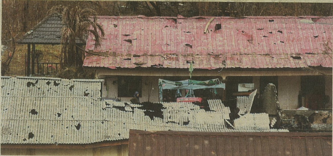
PENDUDUK meninjau rumah yang rosak di Kampung Sungai Luar Dalam semalam susulan kebakaran membabitkan saluran paip gas sepanjang 500 meter di Putra Heights. - Gambar NSTP/HAIRUL ANUAR RAHIM
