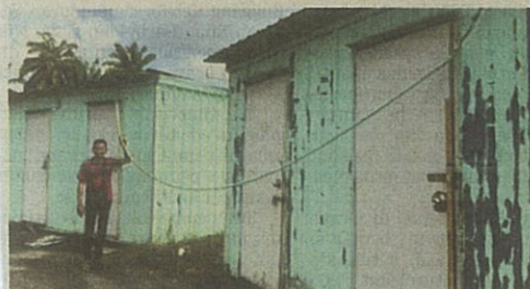
Ramli menunjukkan kabel elektrik yang terjuntai di pusat penjaja dekat bulatan MARDI di Kluang. (Foto Mohamad Fahd Rahmat/BH)
