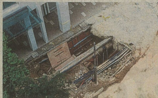
Kejadian tanah jerlus di Jalan Masjid India, Kuala Lumpur 23 Ogos lalu.
