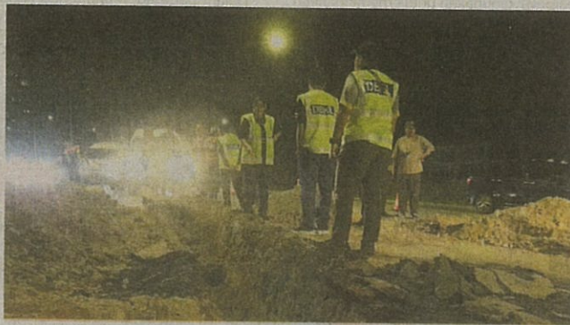
DBKL keluaran lapan notis kompaun terhadap kontraktor korek jalan yang tidak mematuhi SOP.
