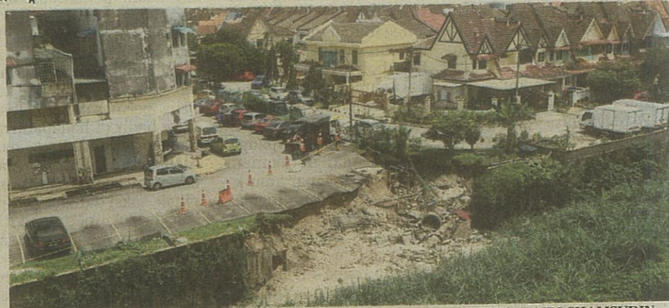
TINJAUAN keadaan tebing sungai runtuh di Taman Lembah Maju. NSTP/EIZAIRI SHAMSUDIN
