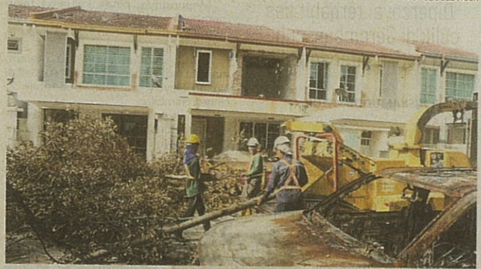
Kerja pembersihan di penempatan terjejas kebakaran saluran paip gas Putra Heights, Subang Jaya dilaksanakan pada Sabtu dan Ahad lalu.
