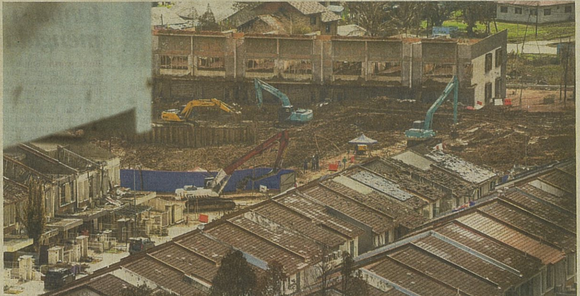
KESAN kebakaran saluran paip gas masih jelas kelihatan di Jalan Putra Harmoni, Putra Heights ketika tinjauan, semalam.
