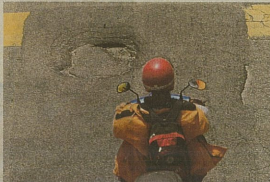
Jalan berlubang dan tidak rata sekitar Kuala Lumpur mengundang bahaya kepada pengguna jalan raya. (Foto Mohamad Shahril Badri Saali/BH)
