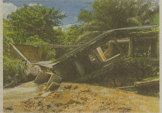
Keadaan jambatan yang runtuh menyebabkan jalan ke tiga pusat rekreasi terputus di Sungkai, Perak.
