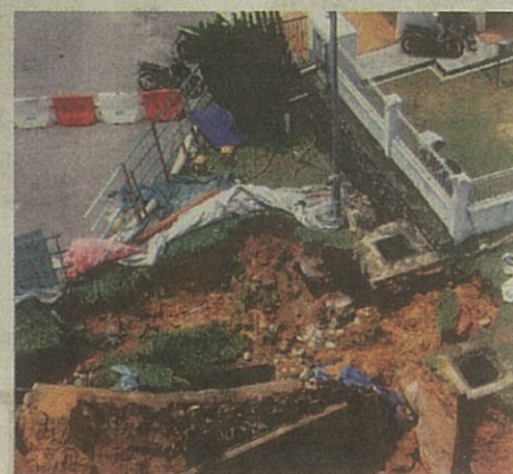
MENDAPAN berpunca daripada pemasangan cerucuk gagal.
