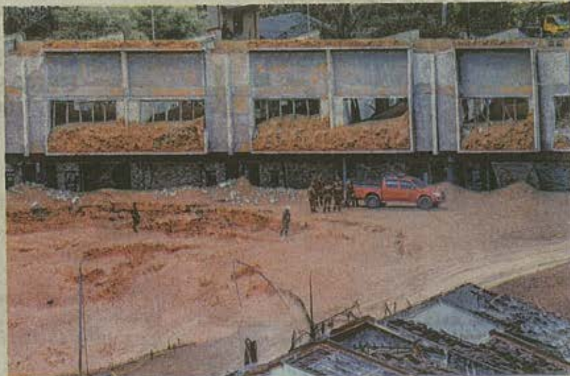
ANGGOTA Bomba dan Penyelamat meninjau keadaan semasa lokasi kejadian kebakaran paip gas Jalan Putra Harmoni di Putra Heights semalam. - UTUSAN/SHIDDIQIIN ZON
