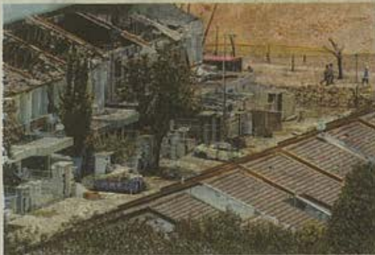
SEBAHAGIAN kediaman yang rosak teruk akibat insiden kebakaran saluran paip gas di Putra Heights, Subang Jaya.
