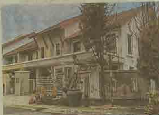
Kebanyakan rumah diletakkan dalam kategori selamat dihuni hanya mengalami kerosakan kecil seperti cermin tingkap pecah, selat kerosak bahang kecil pada bumbung dan siling. (Foto: Khairul Mohamad/Utusan)
