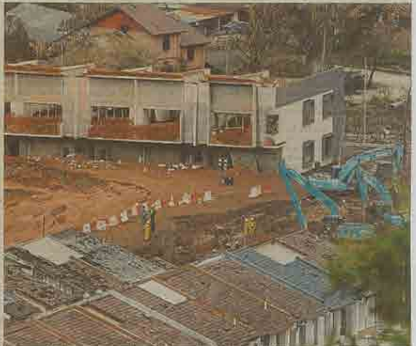
Pasukan melakukan operasi dan penilaian di kawasan kawah kebakaran dan letupan paip gas di Jalan Putra Hormon, Putra Heights, Subang Jaya. (R&O BERNAMA)
