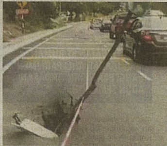
Kerosakan jalan akibat kejadian paip pecah di Lebuhraya Utama Sri Gombak pada Isnin.
